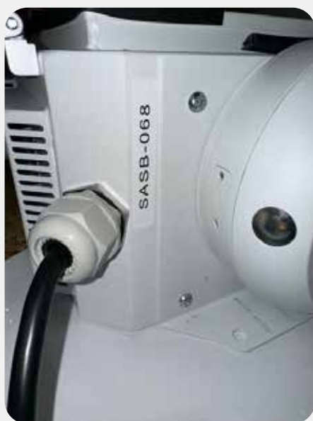
Câbles d'alimentation pour l'activation de la boîte
